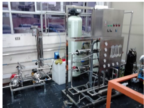
Fig. 1. Unidad de OI del Laboratorio de Control y Automatización de la PUCP.
